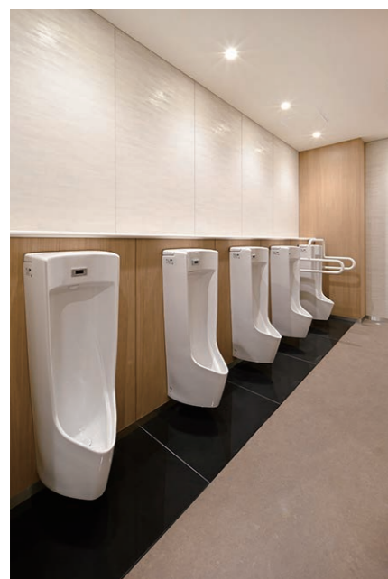
男性用トイレ 小便器
